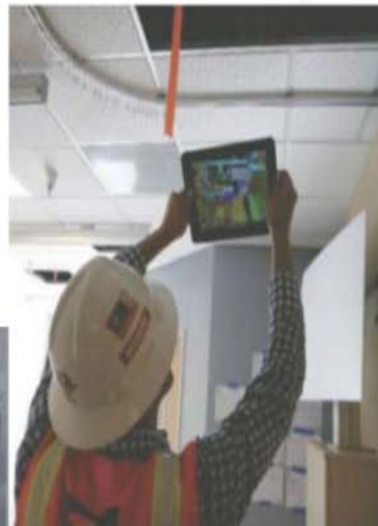
La réalité augmentée permet de visualiser sur la tablette les réseaux derrière le faux plafond.
